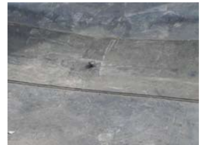
Рисунок 2.5.8 Повреждение мембраны шляпкой самореза при применении тарельчатого металлического держателя по минераловатному утеплителю.
