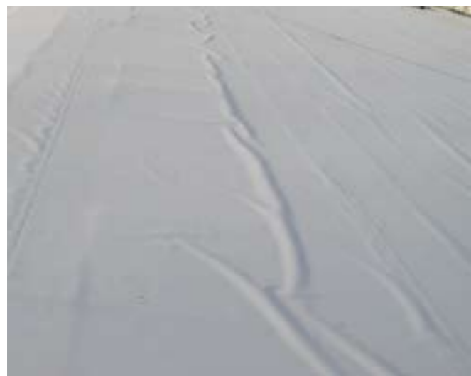
Рис. 2.4.1 Пример складок на ТПО мембране.
